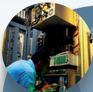
Оборудование для преобразования энергии
